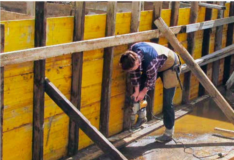
Oddnýju er margt til lista lagt. Hér er hún við mótauppslátt á Butru.
